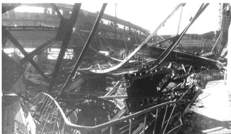
Рис. 2. Вид после пожара с обрушением кровли в машинном зале
